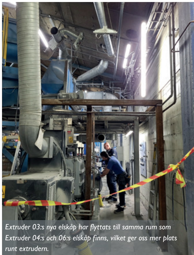
Kablarna dras nu genom rören i golvet i stället för att använda kabelstegar i taket. Detta skapar en renare installation och bättre utrymme i lokalen.
